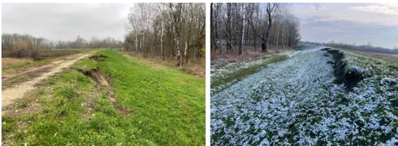
Klizište na savskom odbrambenom nasipu ( lijevo-pogled uzvodno, desno-pogled nizvodno)
