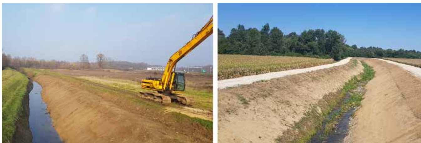
Kanal Svilaj – Potočani prije i nakon sanacije
