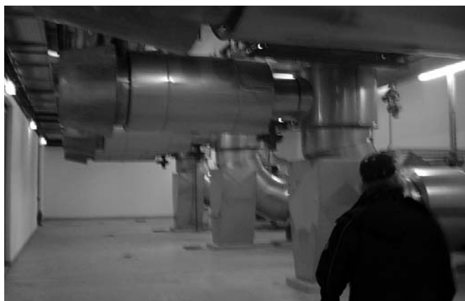
Podzemna galerija instalacija
