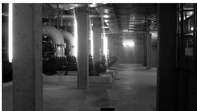
Podzemna galerija instalacija
