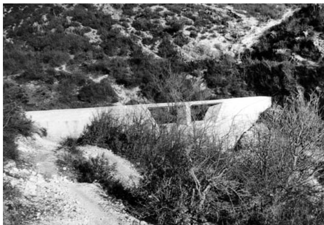
Sl. 2. Pregrada u bujici Mirotninski potok na području Trebinja, koja se koristi i za prelaz preko bujice
