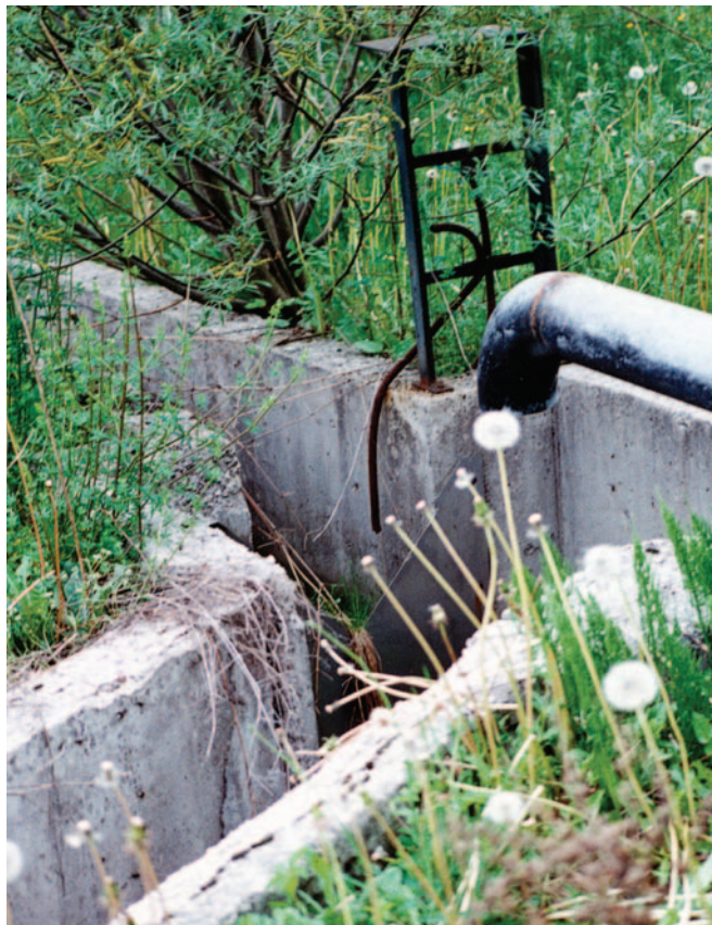
Reciklacija mulja - devastirano postrojenje za tretman otpadnih voda u Trnovu
