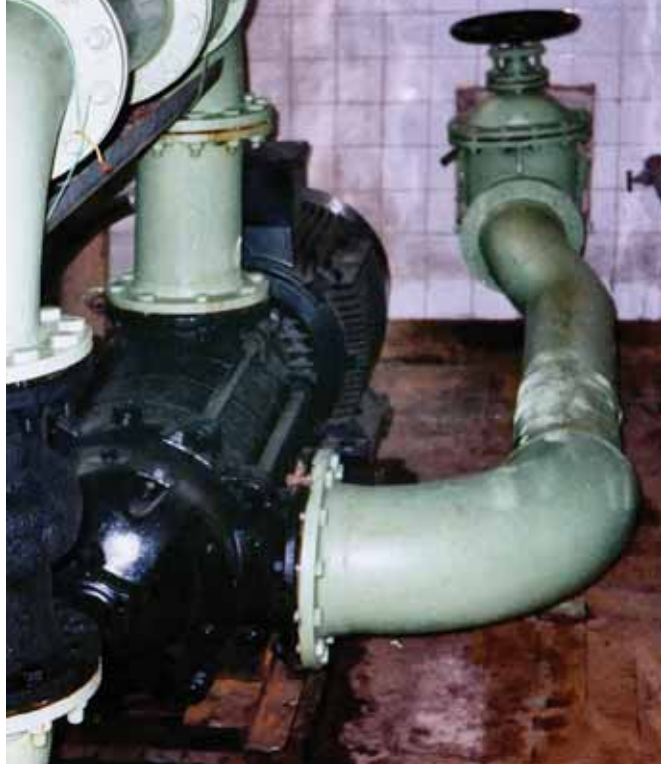
Detalj sa pumpne stanice lokalnog vodovoda
