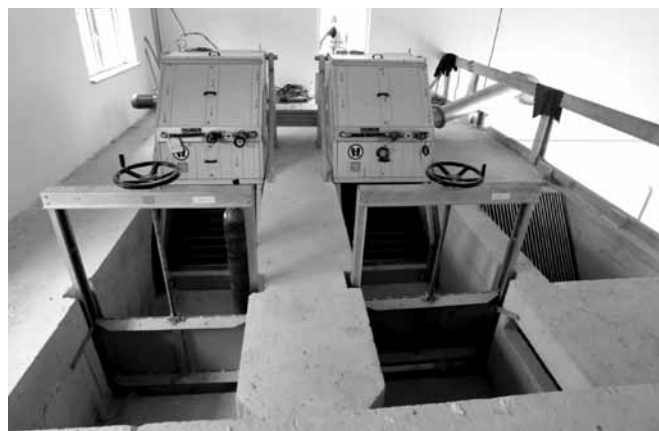
Slika br.9: Objekat finih rešetki – ustave i rešetke
