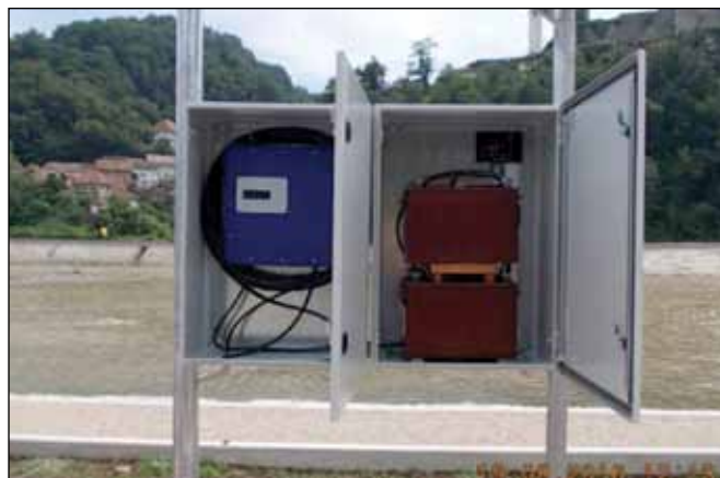
Slika 15.: Pripadajuća oprema automatske stanice za mjerenje protoka srednjih i velikih voda – rijeka Bosna - Maglaj Grad
