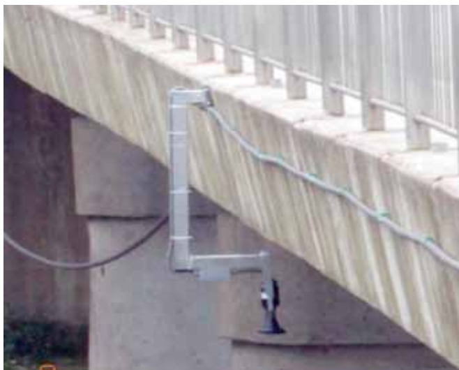
Slika 2.: Radar senzor – automatska hidrološka stanica
