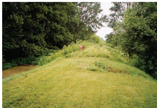
Održavanje nasipa uz r. Savu je ograničeno zbog velikog broja mina (na slici se vidi oznaka upozorenja na mine)
