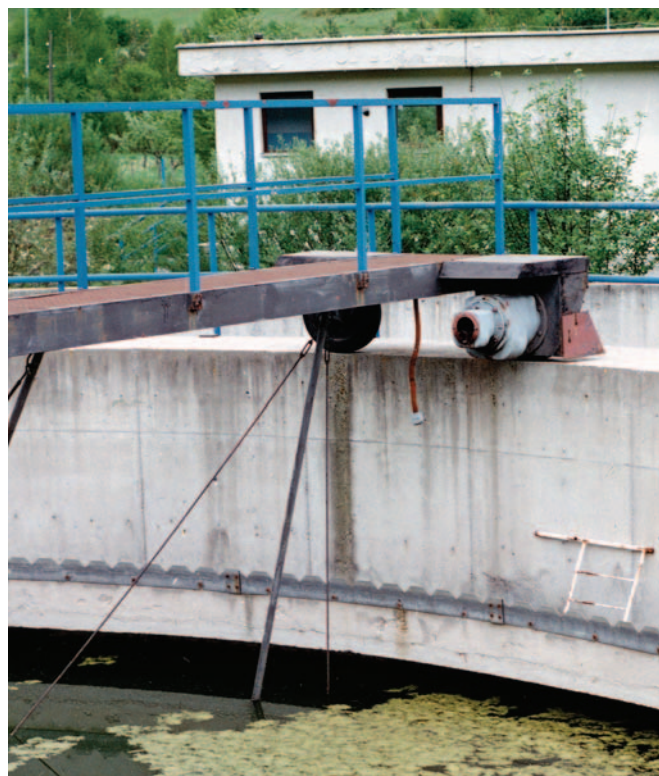
Devastirano postrojenje za tretman otpadnih voda u Trnovu - detalj zgrtača mulja
