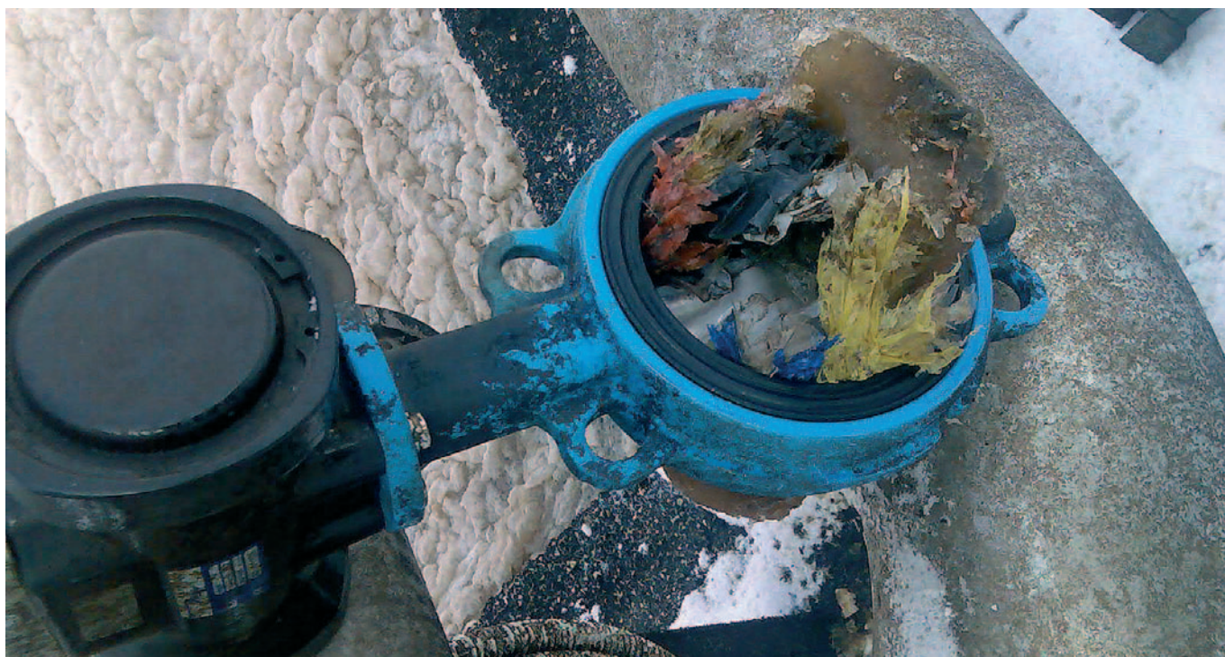
Slika 11. Problemi u održavanju postrojenja
