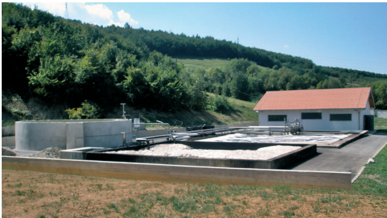
Slika 10. MBR postrojenje za tretman procjednih voda na sarajevskom odlagalištu kućnog otpada- probni rad 2008. god.
