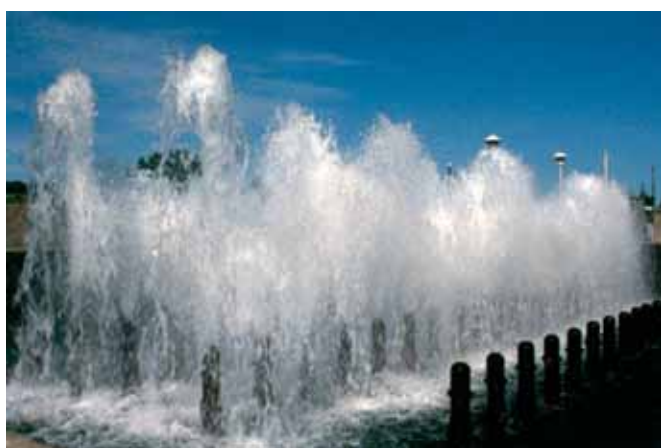
Detalj aeracije vode u postrojenju
