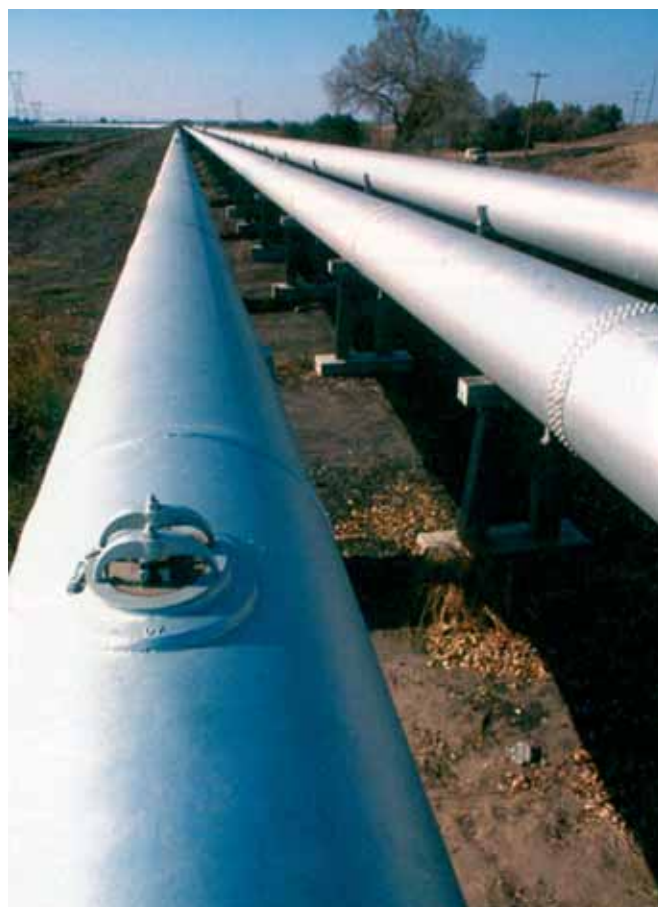
Tri dovodna cjevovoda sa akumulacije Pardee
