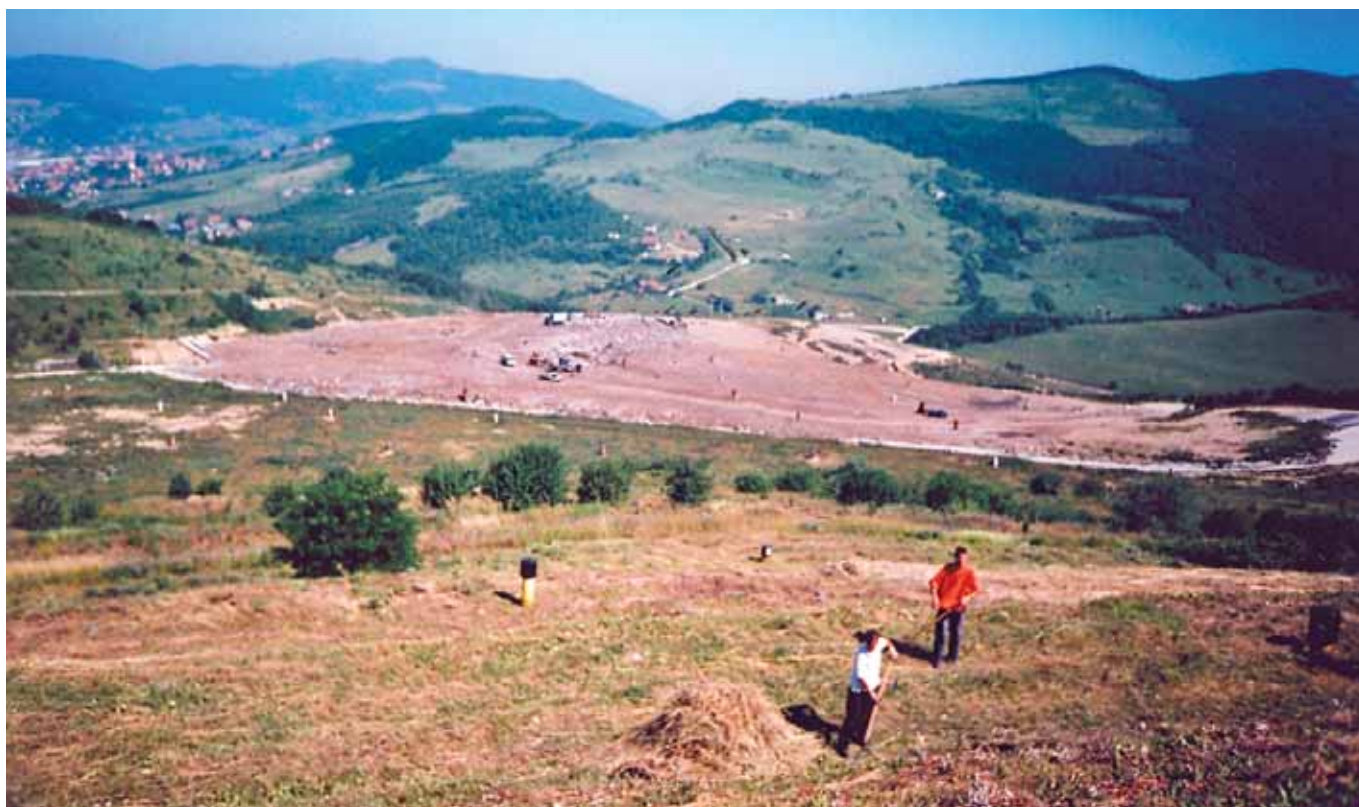
Sl. 12. Sarajevo – Buća Potok – na jednom dijelu oštećenih zemljišnih površina izvedena je sanacija, uz nanošenje povoljnog prirodnog sloja.
