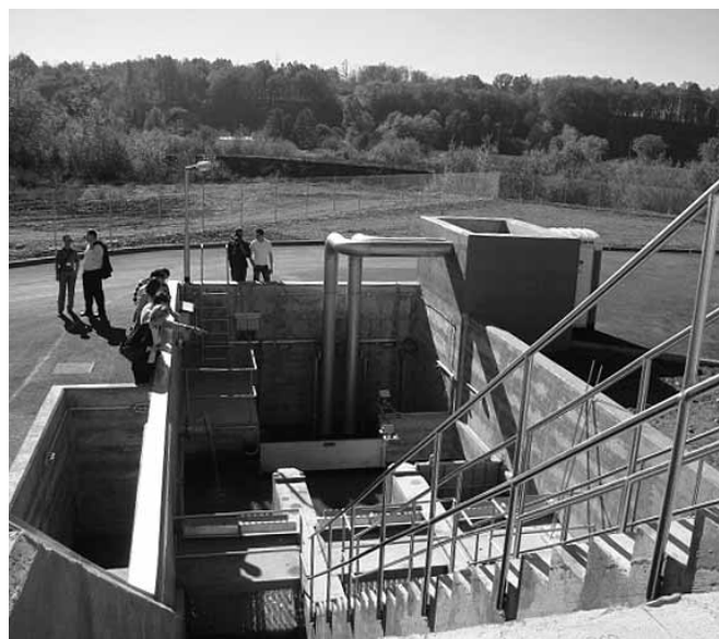
Pogled na dio PPOV Živinicama (ulazna građevina, grube rešetke, fina rešetka oborinske vode sa pumpnom stanicom)
