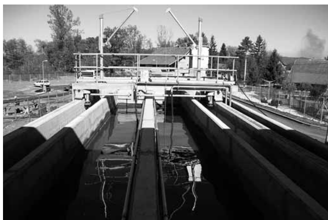
Aerisani pjeskolov/mastolov sa instaliranim prokretnim mostom sa zgrtačem
