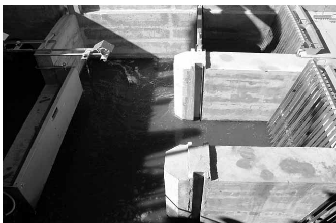
Ulazna građevina i grube rešetke PPOV
