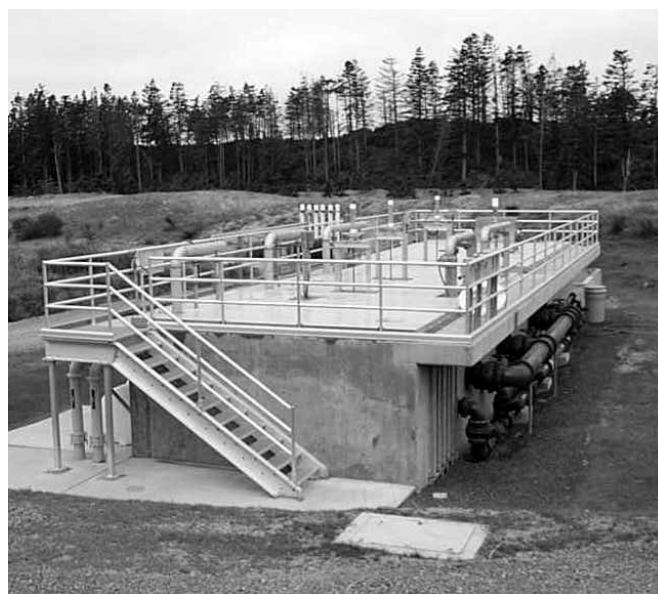
Slika 3 – Postrojenje sa MBR postupkom
