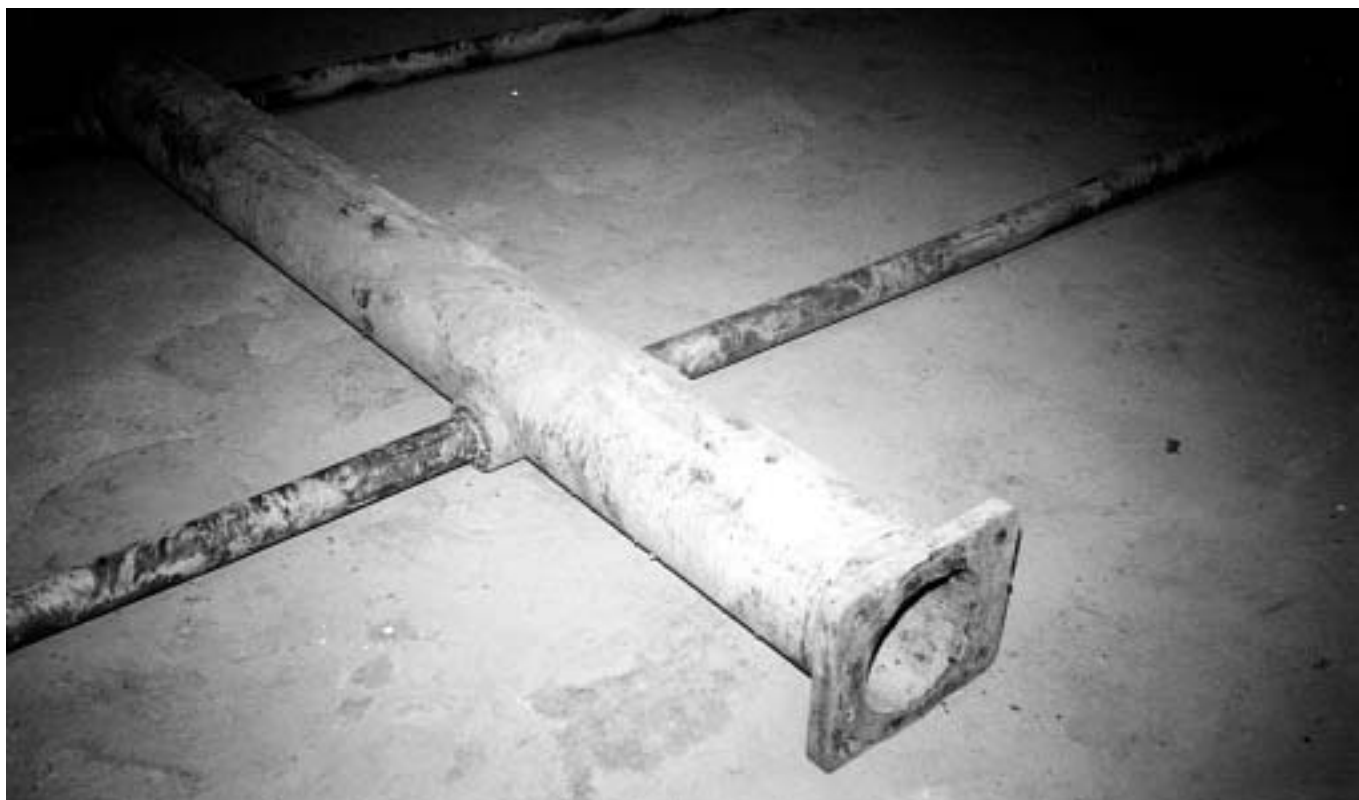
Slika br. 4 Izgled demontiranog segmenta razvoda zraka
