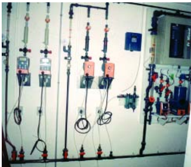
Slika br. 3 – Izgled instaliranog BelloZon aparata za proizvodnju ClO 2
