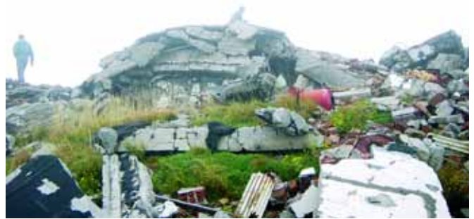
Slika 7. Razoreni vojni objekti na Bjelašnici
