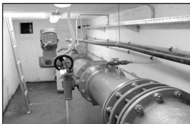
Slika br.5 Foto nove opreme u vodomjernom šahtu
