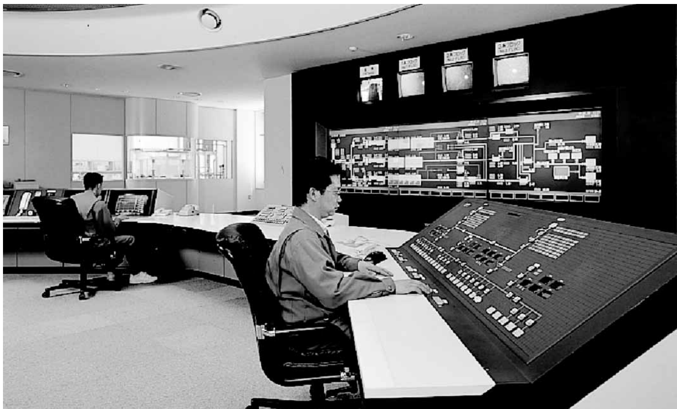
Slika 3: Automatizovana kontrola pripreme vode za piće - Japan
