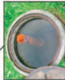
Prozira prečišćena otpadna voda u ispunjenom odvodnom šahtu BiCon prečišćivača sa trskom.
