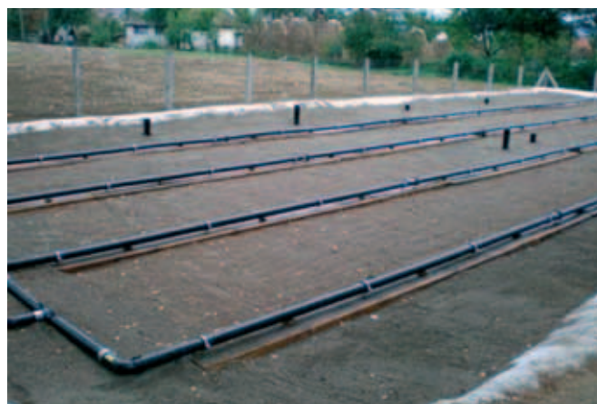
Prokapne cijevi na filterskoj lijehi
