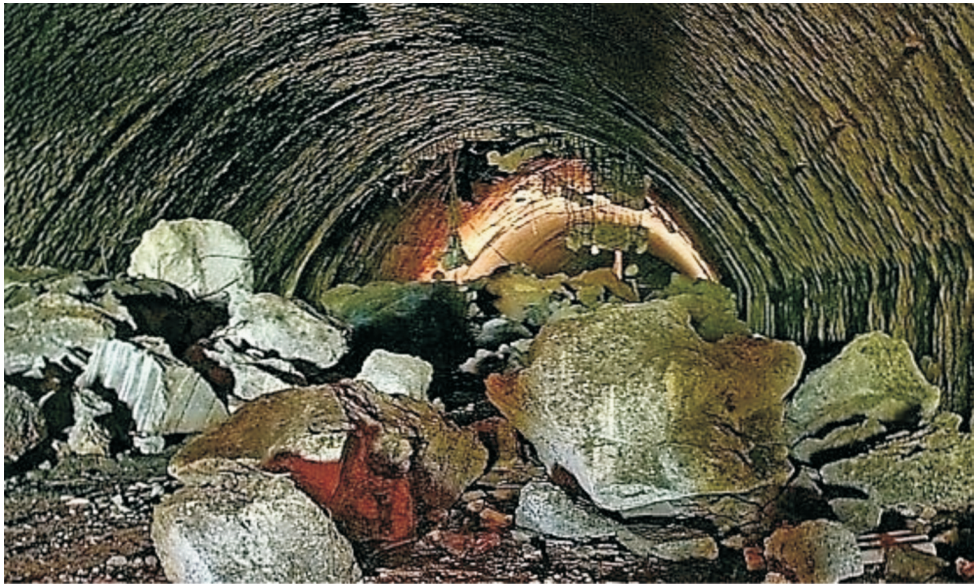
Sl. 7. Posljedice eksplozije unutar tunela 4 (foto H. Grgić)
