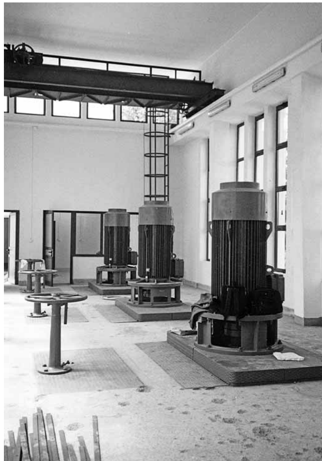
Detalj postrojenja sa obnovljenim pumpama u C.S. “Đurići”
