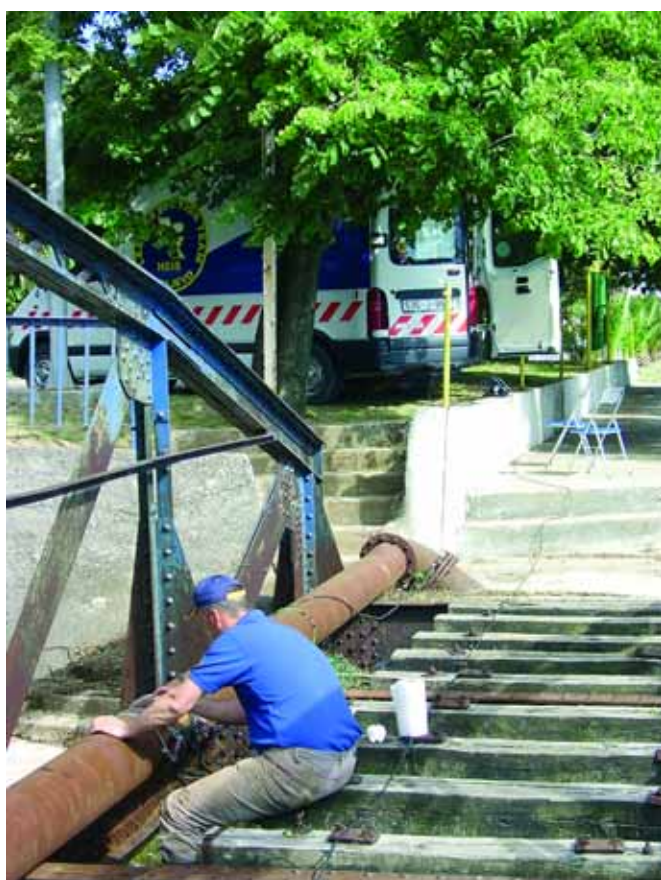
Slika 5: Instalacija prijenosnog ultra-zvučnog mjerača protoka (Zelenika – Herceg Novi)
