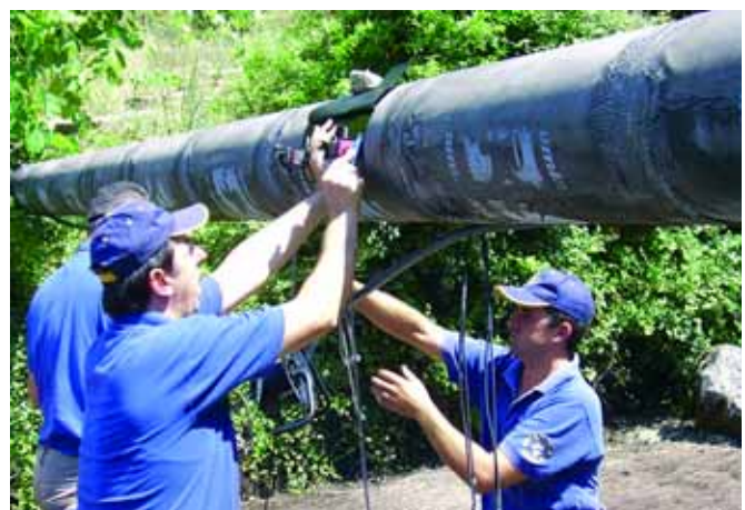
Slika 10: Instalacija sonde prijenosnog ultra-zvučnog mjerača protoka u Petrovcu
