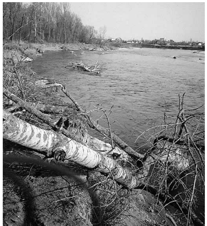
Oštećena obala rijeke Bosne kod Šamca
