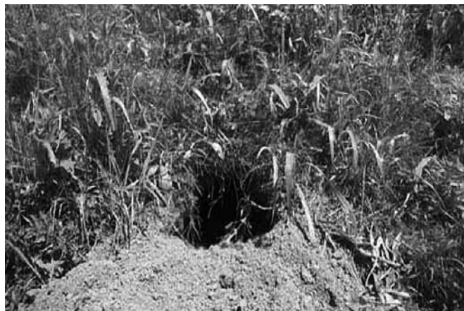
Oštećenja od jazavaca na savskom nasipu
