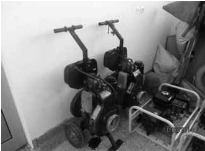
Foto 2: Još jedan dio skladišta za smještaj opreme za odbranu od poplava
