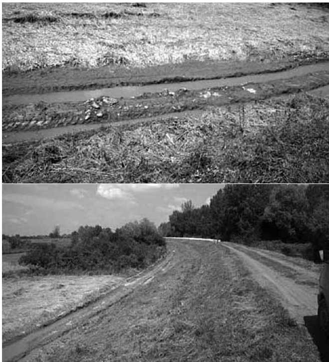
Oštećenja na putu uz savski odbrambeni nasip
